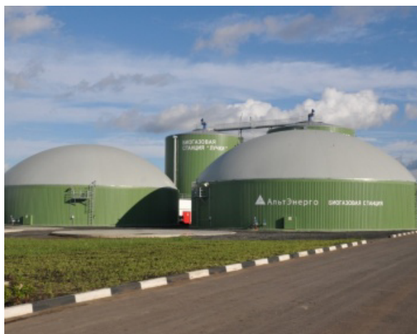
Рис. 2. Биогазовая станция «Лучки»
